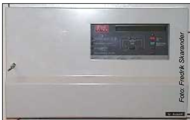
Figur 2.1 Foto på centralapparaten hos brandlarmsystemet EBL512.
